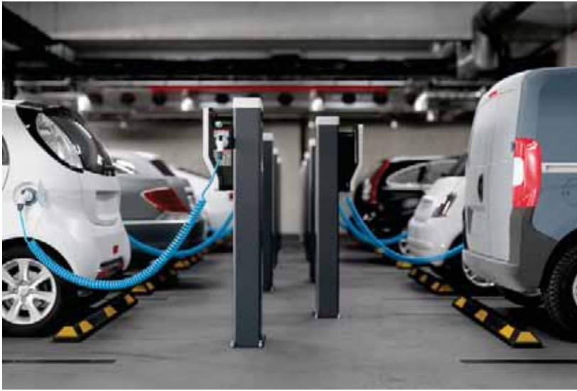
Abb. 4.5: Ladeinfrastrukturen in Garagen sind ohne besondere brandschutztechnische Maßnahmen zulässig. (Foto: © istock.com/onurdongel)
