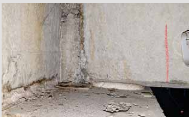
Abb. 5.4.3: Gleitlager mit Asbestschnur im Stahlbetonbau
