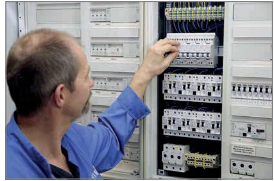
Bild 1: Verteilerschrank einer Elektroinstallation mit Schutzschaltern www.siemens.com
