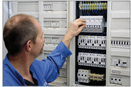
Bild 1: Verteilerschrank einer Elektroinstallation mit Schutzschaltern www.siemens.com
