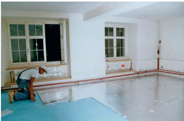
Abb. 5.2: Oben: Verschiedene Vakuumisulationspaneele [RK-Stuttgart], unten: Montage der VIP-Fußbodendämmung im historischen Gerichtsgebäude von Schaffhausen [ZZWancor, Porextherm]
