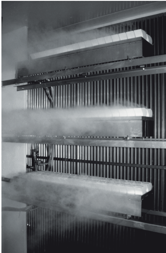
Abb. 23.8: Ultraschallbefeuchter in einer begehbaren Befeuchtungskammer
