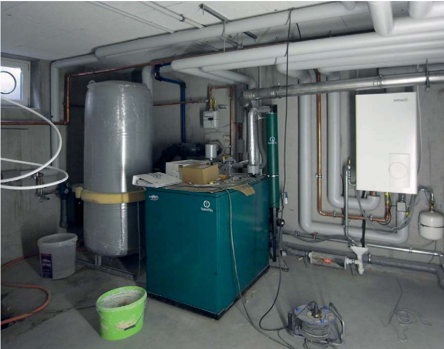
Abb. 6.3: Das Blockheizkraftwerk im Keller
