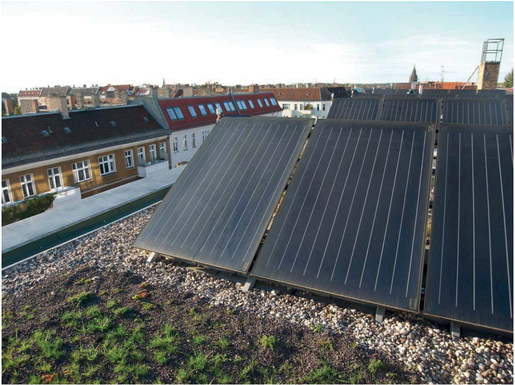
Abb. 6.2: Thermische Solaranlage zur Warmwasserbereitung
