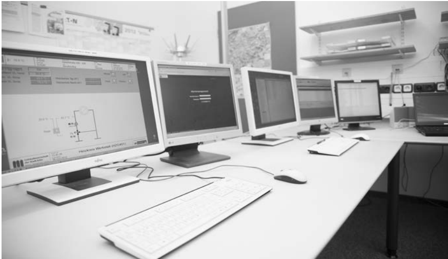
Abb. 4: Arbeitsplatz (Managementebene) für die Bedienung der Gebäudeautomation
