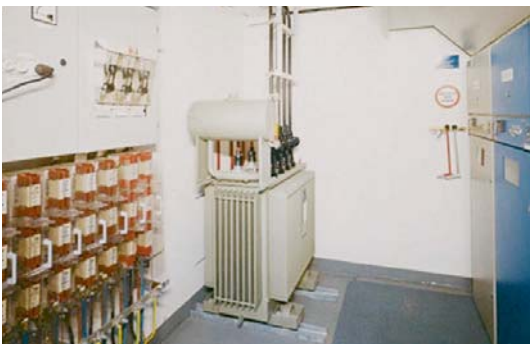
Bild B 4: Das Innere einer begehbaren Station
