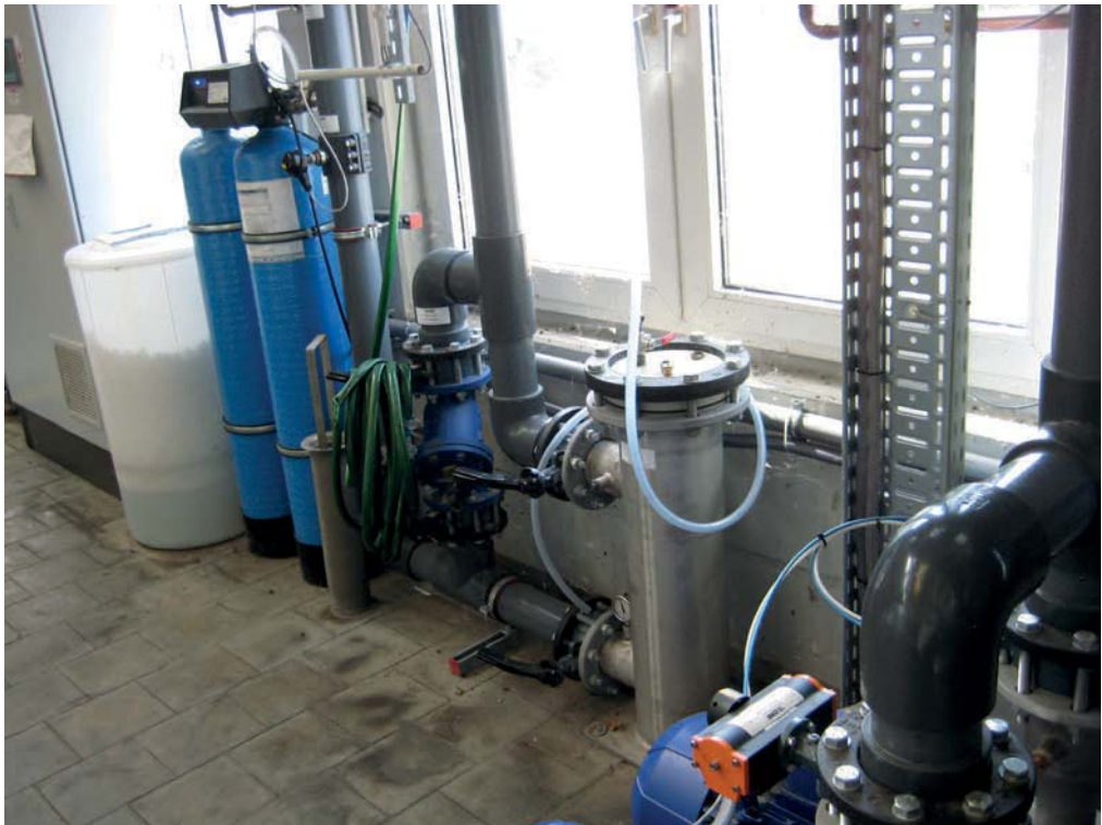
Bild 5.3: In der Wasseraufbereitung kommt es bei Überdimensionierung oder eingebauten Bypässen schnell zur Stagnation des Kühlwassers (Bild: DMT)
