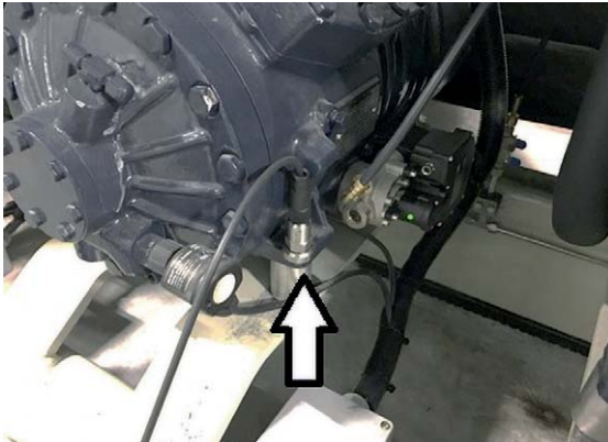
Abb. 2.10 Beschleunigungssensor an einem Verdichter
