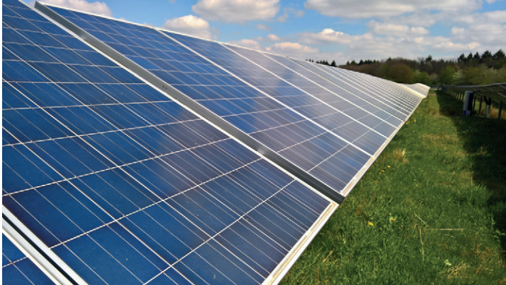
Bild 7.1 PV-Generator einer Freiflächenanlage
