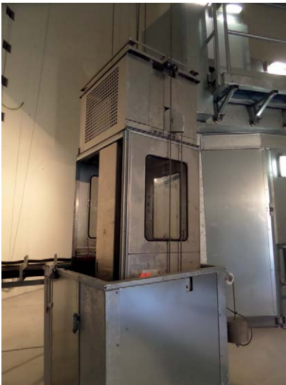
Bild 4.40 Aufstiegshilfe (Fahrkorb) in einem Fertigteil-Betonturm
