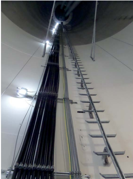
Bild 4.43 Innenansicht Fertigteile-Betonturm mit Energie- und Kommunikationsleitungen, Steigleiter mit Schienensystem und Turminnenbeleuchtung
