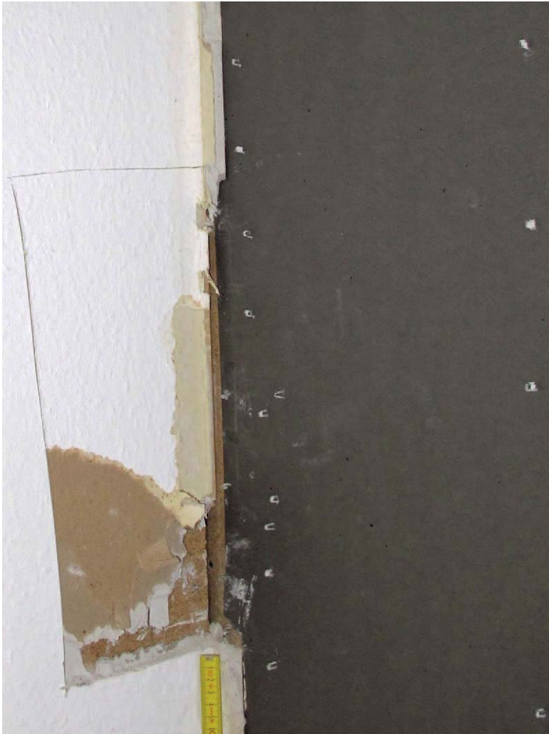
Abb. 10.22: Die Luftdichtheitsschicht war am Innenwandanschluss nicht luftdicht weitergeführt worden
