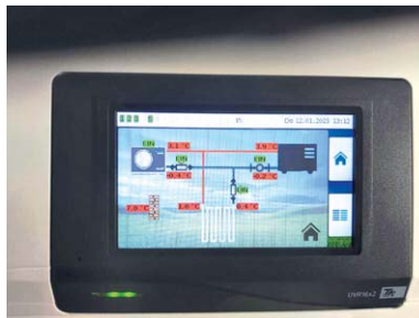
Abb. 2.9: Luft/Sole-Wärmeübertrager (Fabr. Vaillant) zur Regeneration eines Grabenkollektors (oben); b) Ansicht des Reglers für den Luft/Sole-Wärmeübertrager und den Grabenkollektor (unten) (Fotos: Seifert Haustechnik GmbH, Lößnitz)
