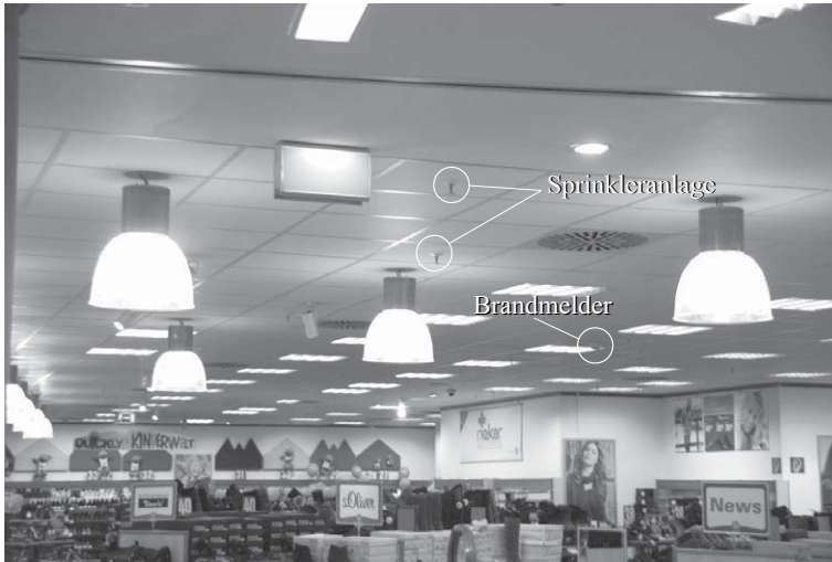
Bild 2.79 Beispiel für Sprinkleranlage und Brandmelder im Verkaufsraum
