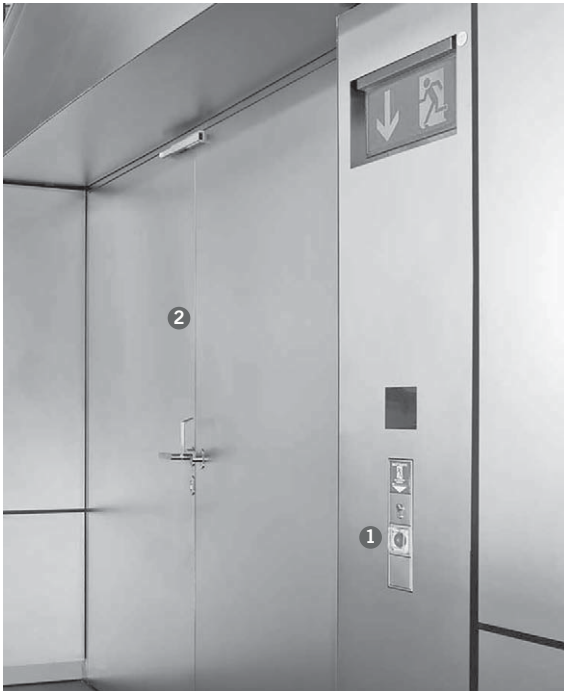
Bild 2.73 Tür im Rettungsweg mit elektrischer Verriegelung und Nottaster –
