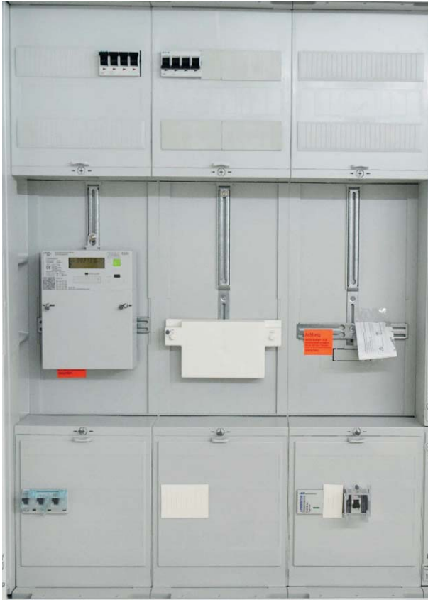
Bild 7.6 Zählerplatz mit Reserveplätzen
