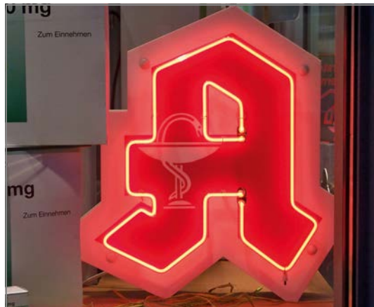
Bild 1: Leuchtröhrenanlage für Spannung bis AC 1000 V
