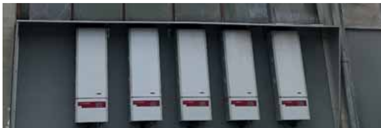
Bild 2.5 PV-Wechselrichter an der Gebäudeaußenseite mit Überdachung
