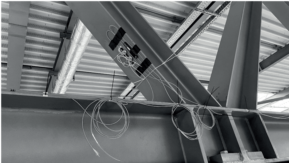
Abb. 7: Installierter DMS an einem Fachwerkträger
